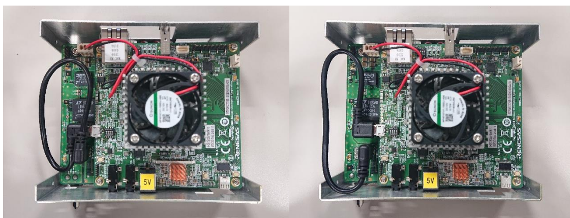
写真 6-9 2 パターンのケーブル接続
